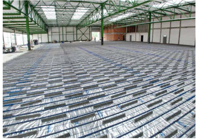
Instalacja ogrzewania podłogowego KAN-therm (1500 m 2 ) w hali przeladunkowej sadzonek sałaty - Kosów.
